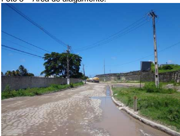
Foto 5 – Trecho com pequenos afundamentos na trilha da roda externa.
