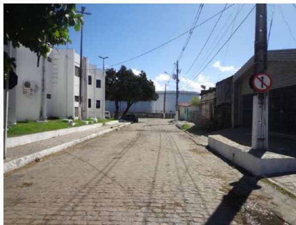
Foto 2 – Afundamento da trilha da roda externa.
