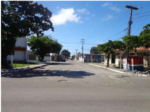
Foto 1 – Área com afundamentos, interseção com a BR-230, Estaca 32 + 17,79.
